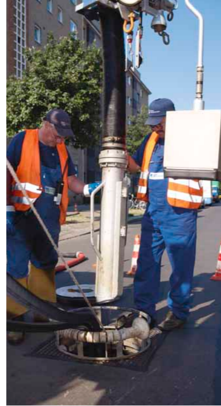
Saugrohr zur Kanalreinigung
